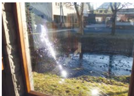
Zastávka-Kozlovice střed-poškozeno asi 8.3. - 9.4. 2014, foto archiv obce
